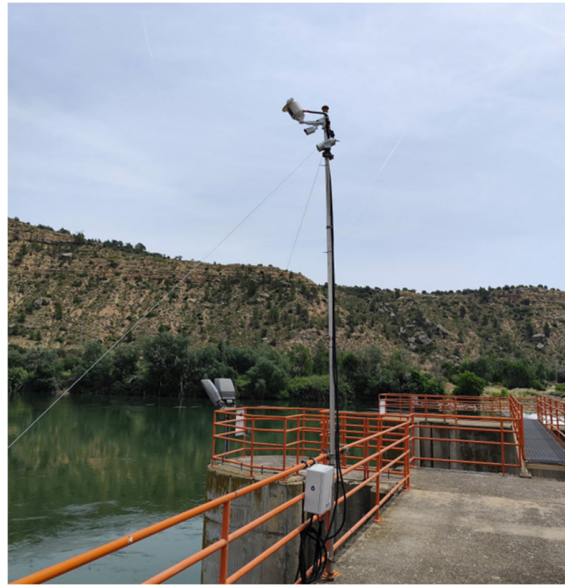
Figura 1. Mástil con sistema de cámaras y armario eléctrico secundario
